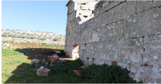
الصورة رقم (14): توضح أثر إطلاق العيارات النارية على جدران كنيسة موقع الكفير الأثري، تصوير الباحث، عام 2024م.
